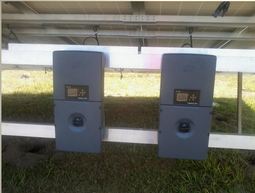
Conjunto de inversores de um sistema fotovoltaico
