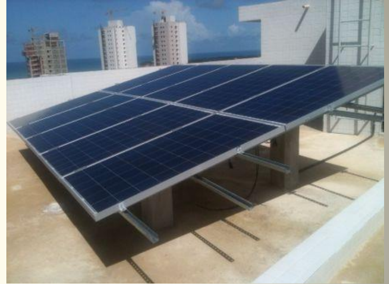
Sistema fotovoltaico instalado em João Pessoa - PB
